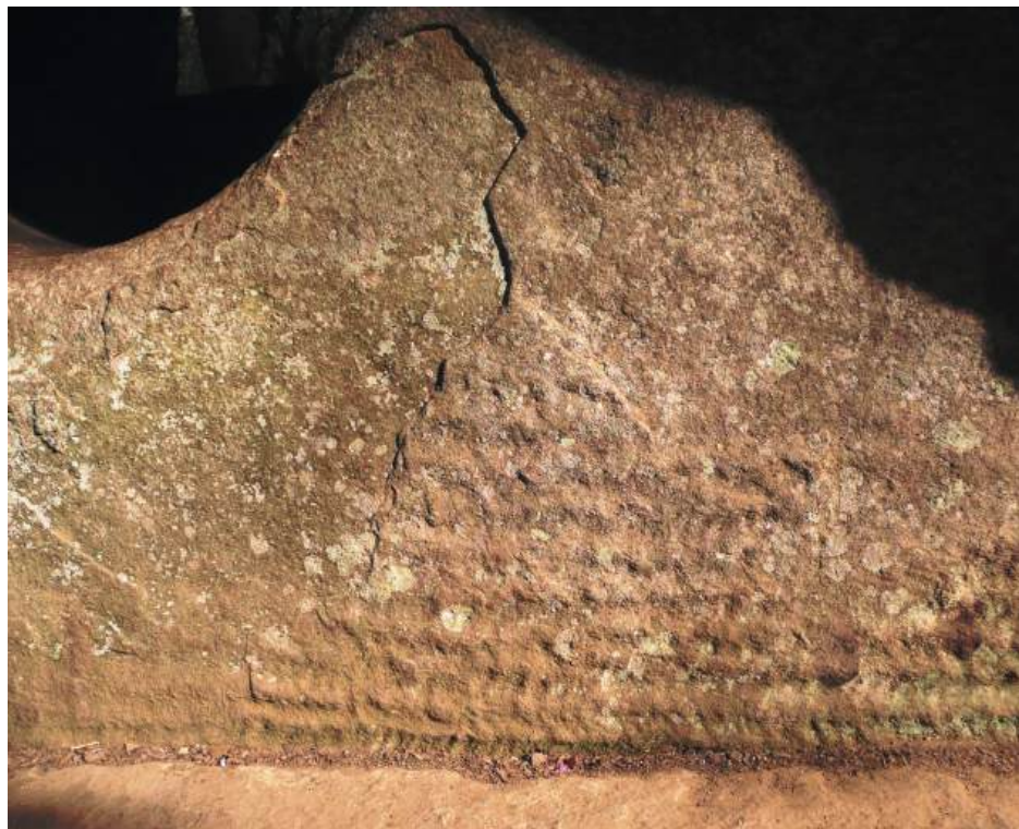
Рис. 1. Отслаивание орнамента. Фрагмент фасадной стены дольмена на левобережье р. Пшада
